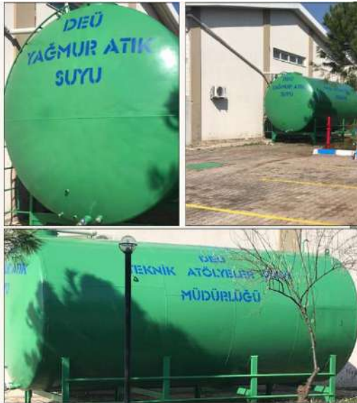
Teknik Atölye Binasında Yağmur Suyu Toplama Sistemi
