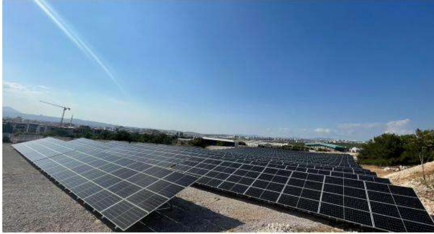
Tınaztepe Kampüsünde Güneş Enerji Panelleri
