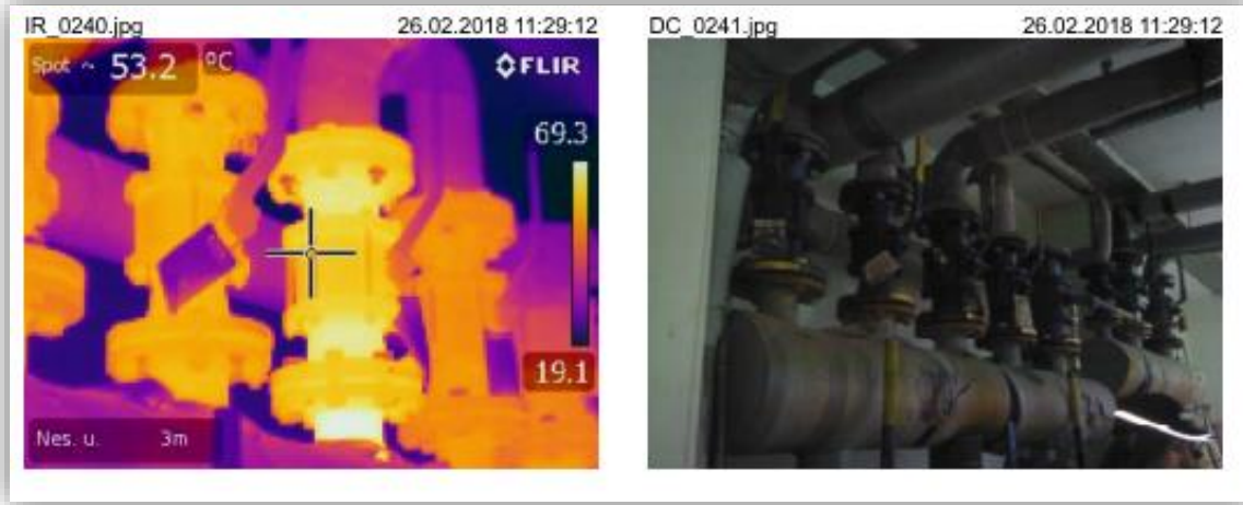
FOTOĞRAF 30 : Yalıtımsız Sıcak Su Tesisatı -1
