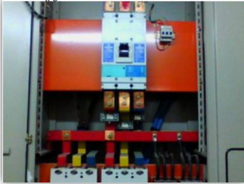
FOTOĞRAF 33: Bina Ana Dağıtım Panosu
