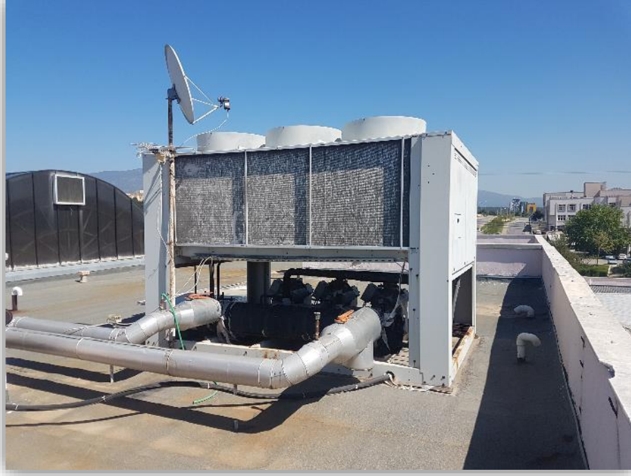
FOTOĞRAF 27: Chiller Görüntüsü
